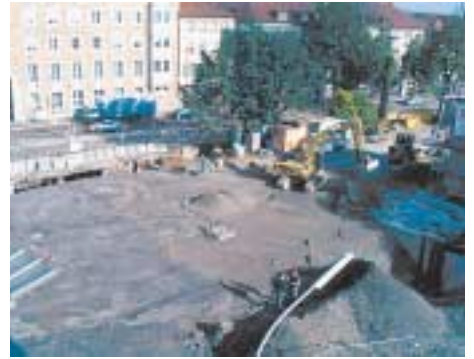
Die östliche Seite der Allee-Unterführung ist bereits rückgebaut, mit dem Rückbau der westlichen Seite ist begonnen.
