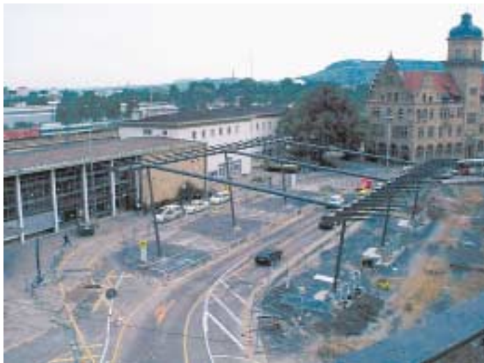
Die Stahlkonstruktion steht, nun fehlt nur noch das Dach: Anfang September werden die Gloselemente montiert. Danach wird das gesamte Umfeld neu gestaltet.
